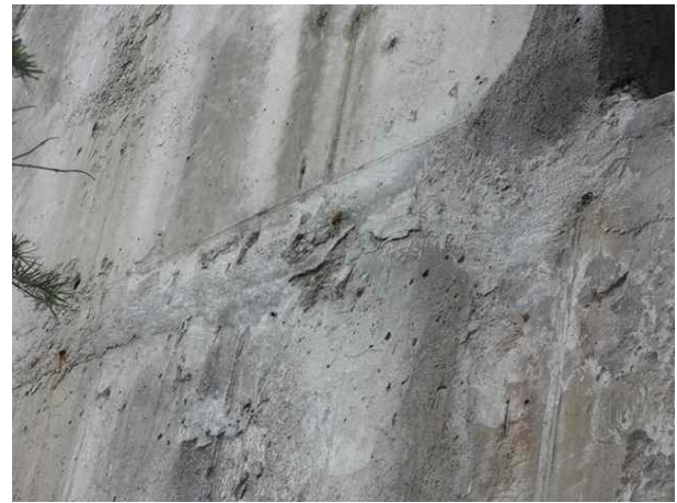
A2 날개벽 콘크리트 박락(0.4m×0.3m)
