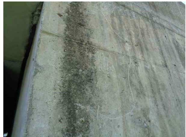
A2 날개벽 균열(0.1mm/1.1m)
