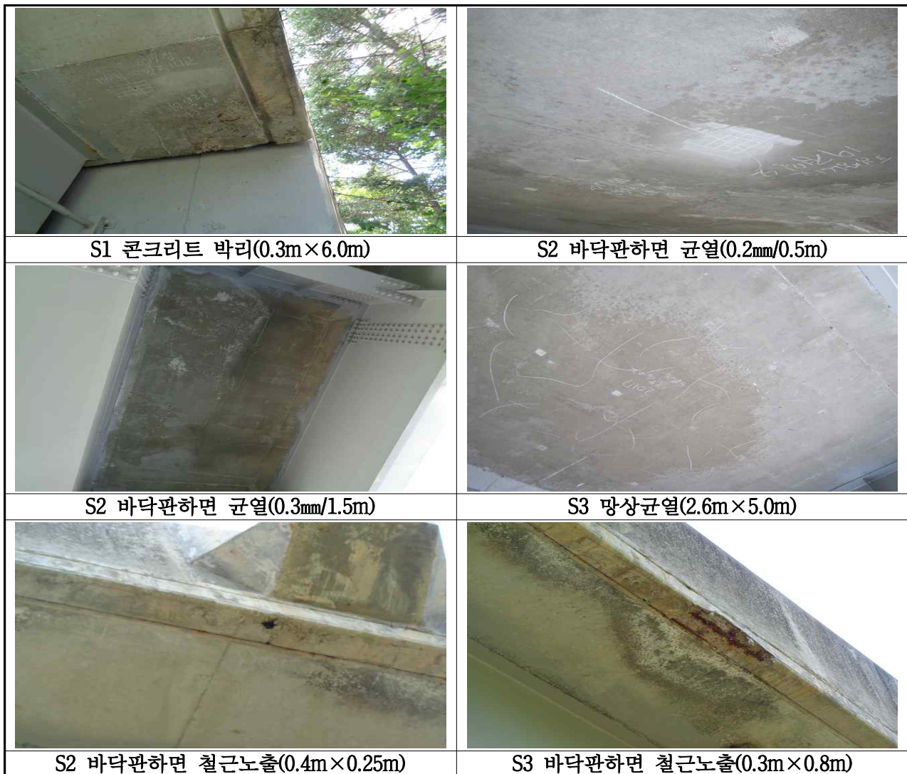
【사진 3.3】 바닥판 손상현황
