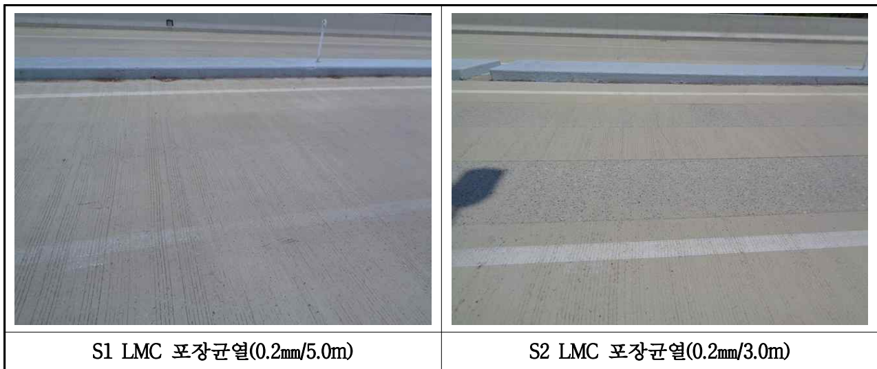
【사진 3.20】 교면포장 손상현황
