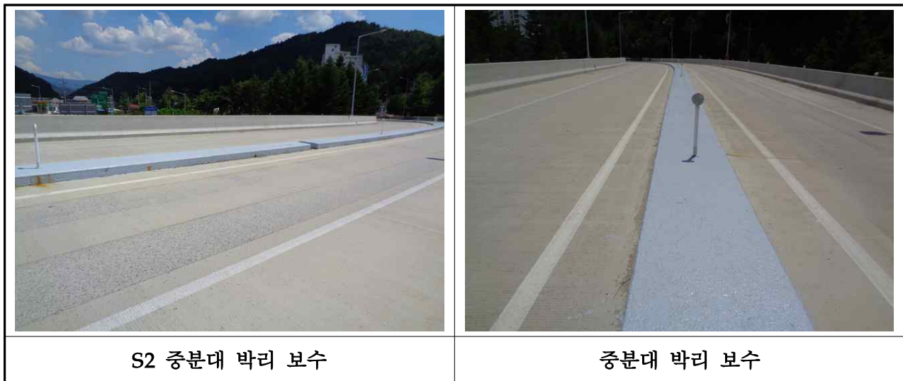
【사진 3.24】 방호벽 및 중앙분리대 손상현황
