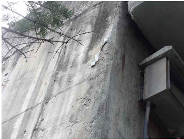
A2 날개벽 콘크리트 박락(0.4m×0.3m)
