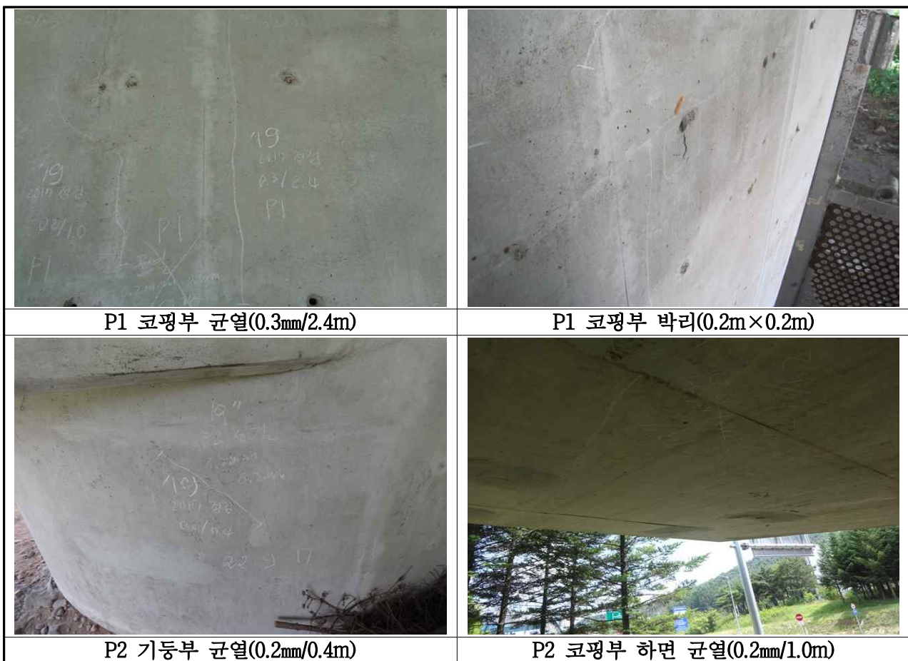
【사진 3.12】 교각 손상현황
