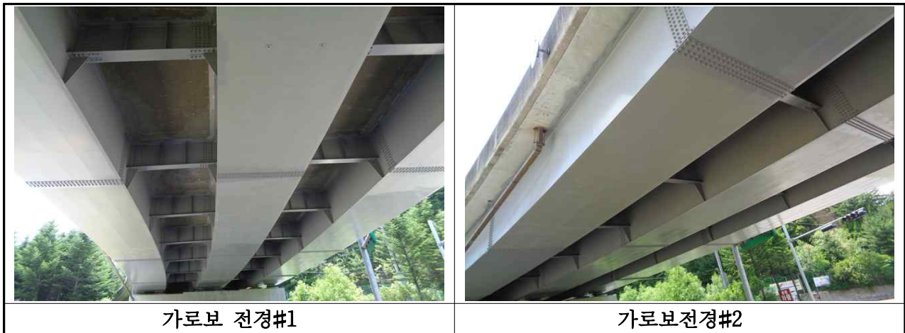
【사진 3.7】 거더 내부 손상현황
