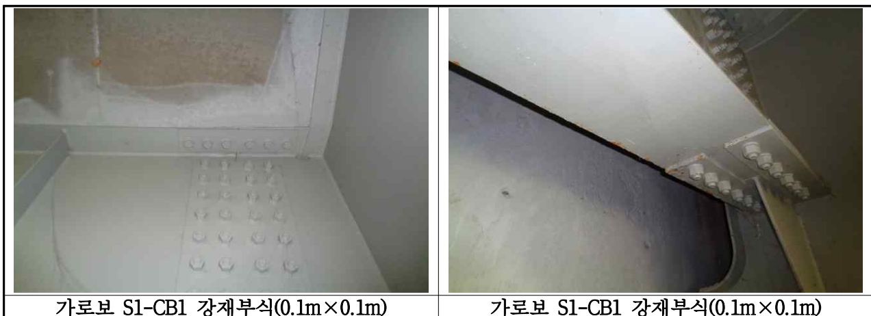
【사진 3.8】 가로보 및 세로보 손상현황
